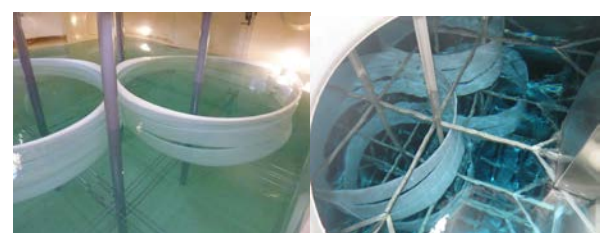
(a) 30t クラスの貯水槽 (b) 大型貯水槽
