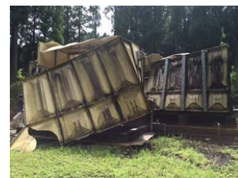
写真 3 完全に破壊された事例 (FRP タンク, 熊本県阿蘇市)
