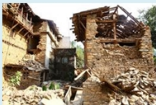
【土レンガ構造建築物の被害】
