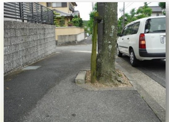
【街路樹の成長に伴う植栽柵の破損】
