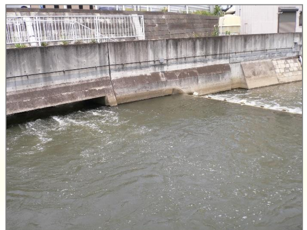
坂川下流部から見た戻り口の状況 右側は坂川の上流部で落差工を利用して逆流 している。左側が下流で浄化された水が江戸 川に向かう
