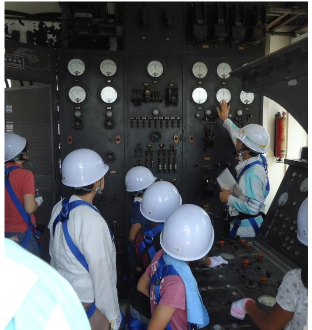
操作盤（右）と配電盤（左）
