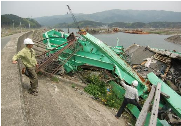
陸前高田市気仙川にて津波で流された橋桁を調査するシニア技術者
