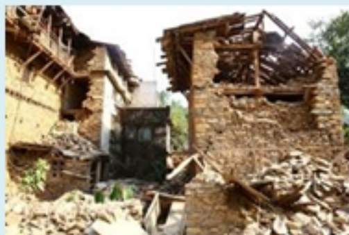
【土レンガ構造建築物の被害】
