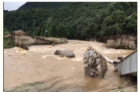
JR芸備線の橋梁流失
