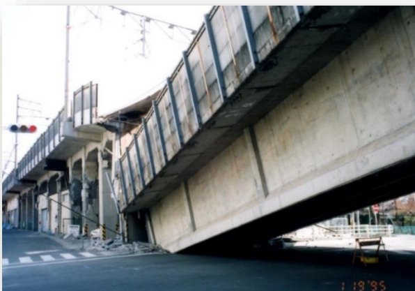
阪神淡路大震災 落下した橋梁
