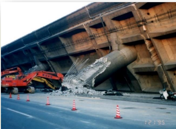
阪神淡路大震災 横転した高速道路
