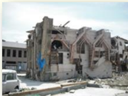
写真-1 液状化の影響によるビルの転倒
