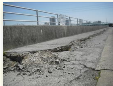
写真-2 液状化による堤防の破壊
