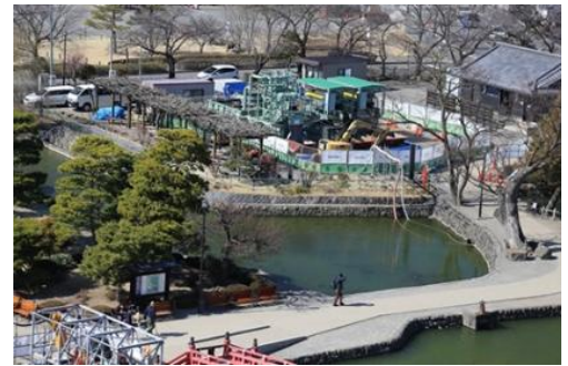
写真-4 堀の浚渫泥水の脱水固化設備
